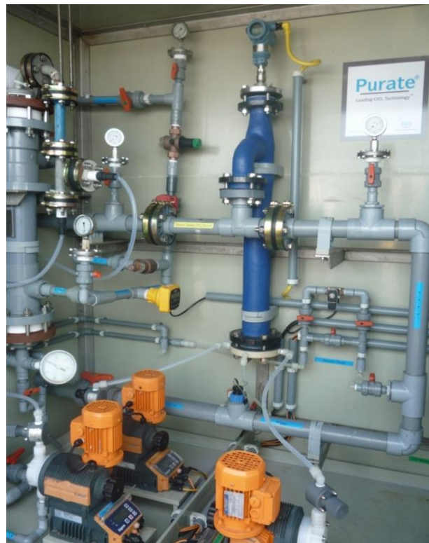
Figura 13. Fluxograma del generador utilizado en la prueba para producir Dióxido de Cloro
