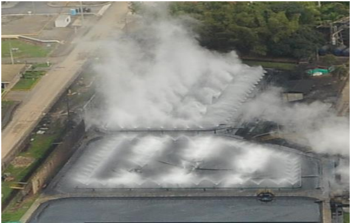
Figura 26. Vista panorámica piscina de aspersión estación Castilla 2
