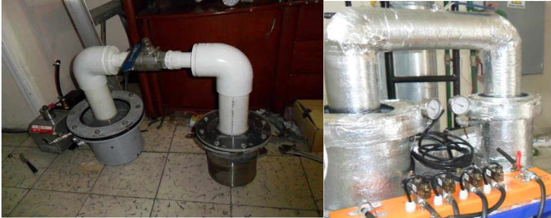
Figura 33. Recubrimiento térmico tanques principales.
