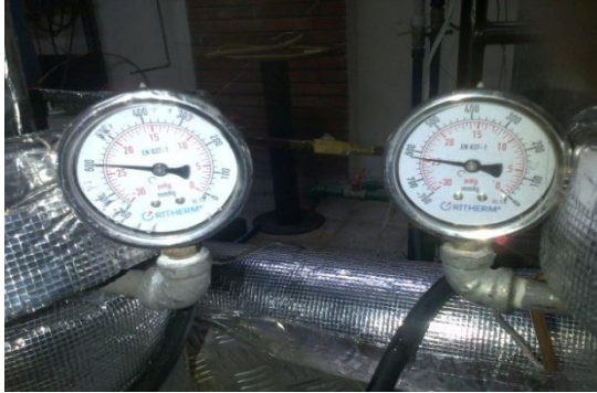
Figura 37. Vacuómetros tanque principales.
