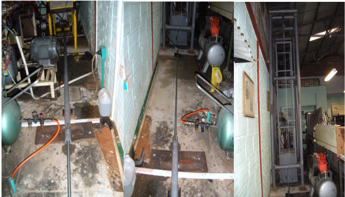
Figura 88. Cilindro hidráulico y estructura tubular.
