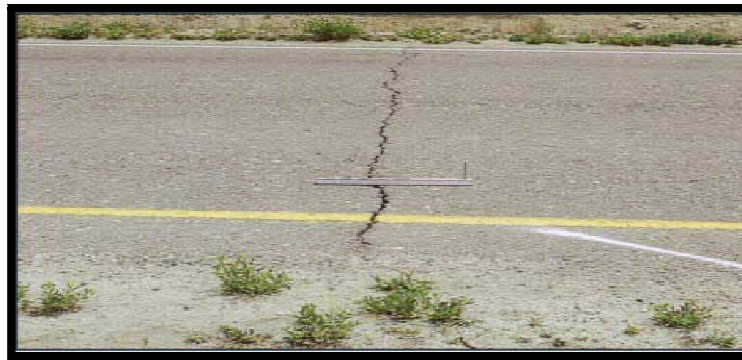
Figura 3. Fisura transversal, atraviesa toda la sección de la carretera
