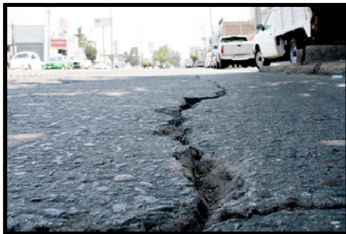
Figura 5. Fisura de borde
