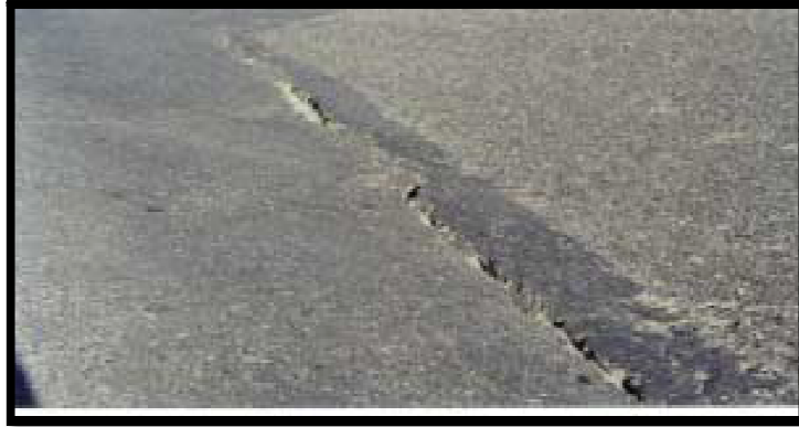
Figura 4. Fisura por reflexión de juntas
