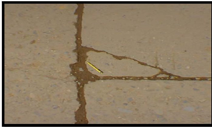
Figura 6. Fisura de esquina
