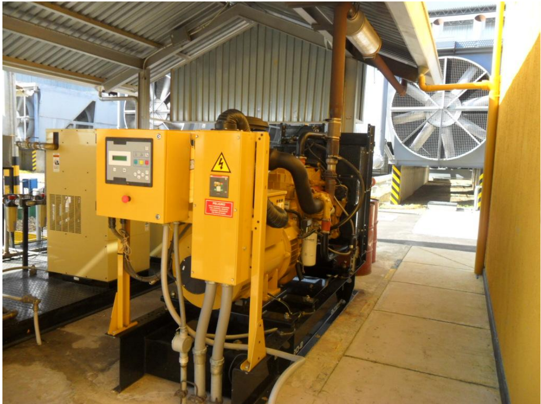
Figura 4.1 Equipo electrógeno de estación de compresión de gas Miraflores
