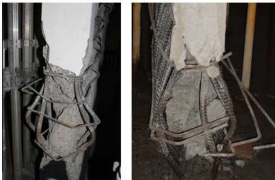
Figura 19. Falla típica a flexión por cargas sísmicas
