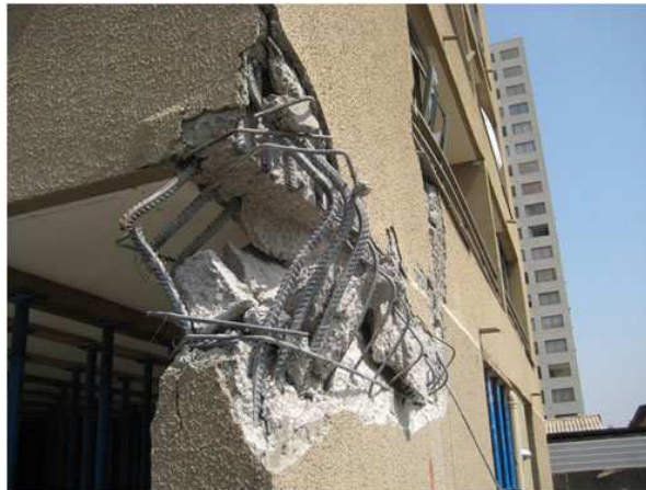
Figura 20. Pandeo de las barras longitudinales sin estribos de confinamiento
