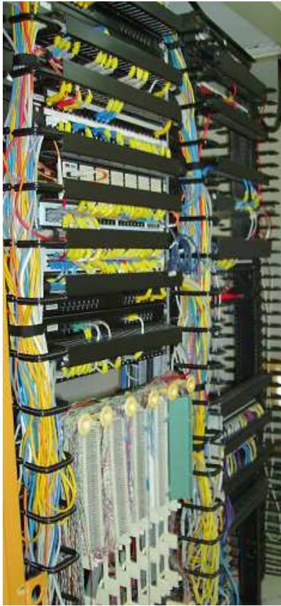
Figura 4.2 Rack frente a publicaciones, verificado y aprobado luego de finalizar el proceso de modernización de la red de datos.
