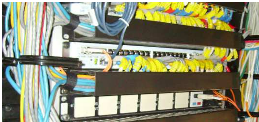
Figura 4.1 Switch 3com 4500G PoE instalado y configurado
