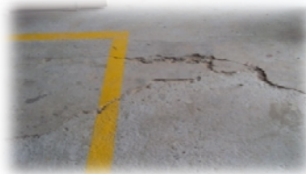
Figura 25. Estado del piso
