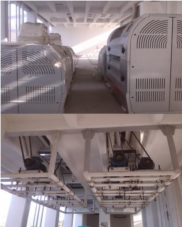
Figura 63. Instalación Bancos de Cilindros
