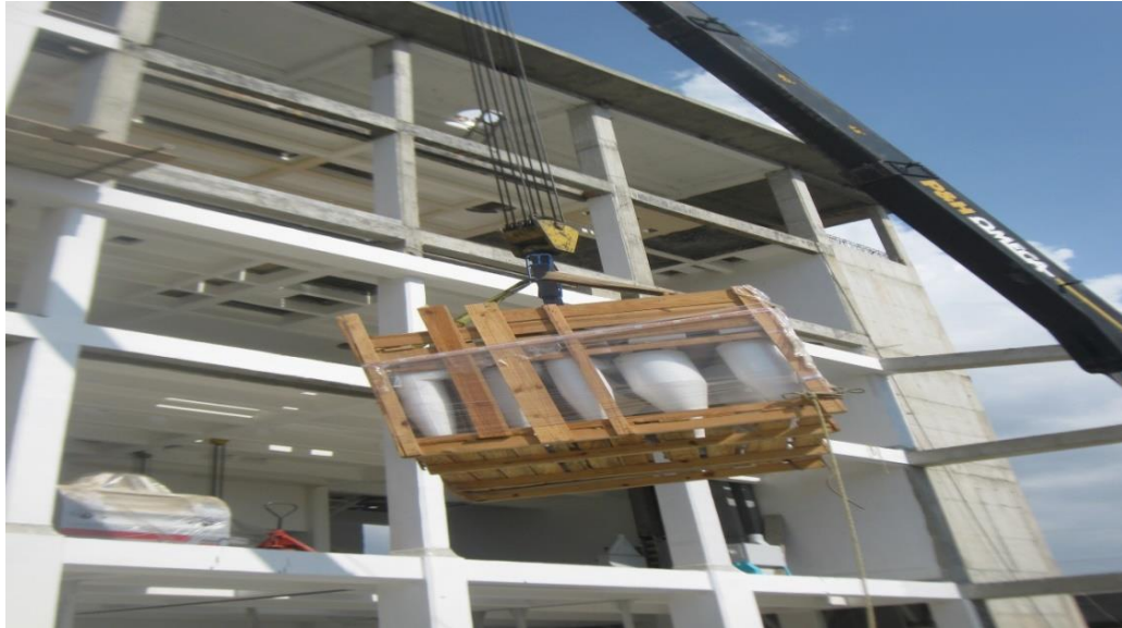
Figura 45. Izamiento de los ciclones y accesorios del sistema neumático
