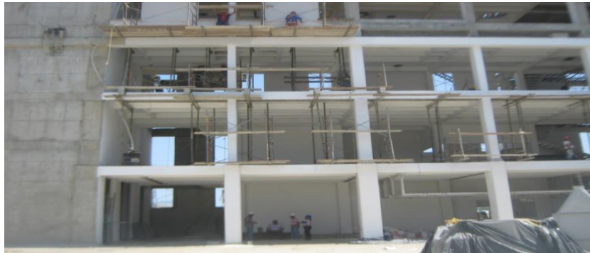
Figura 40. Reconocimiento de Instalaciones y ubicación final de los equipos por piso
