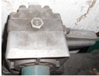
Figura 29. Bomba hidráulica de engranajes
