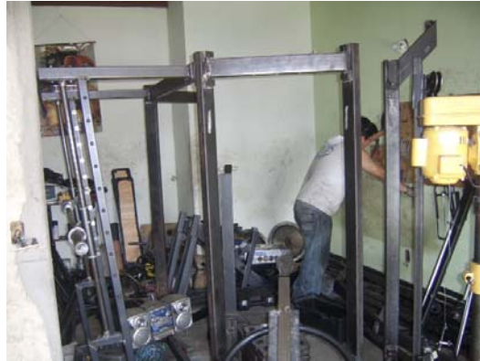
Figura 26. Desarmado del Sistema Multiestaciones
