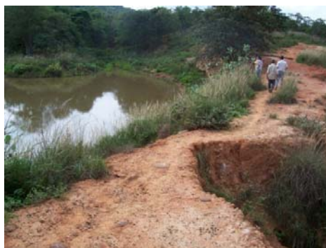
Figura 11. Fallas estructurales laguna de aguas lluvias en la vereda Campo Hermoso
