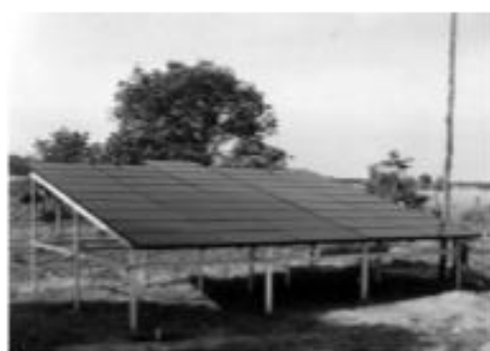
Figura 4. Sistema solar de 2,8 kWp instalado por el antiguo IC21 (Instituto Colombiano de Energía Eléctrica, hoy IRE) en la Verdurera, Vichada, en 1996. Suministra energía a os V AC a una comunidad de 12 familias y tanto escolar.
