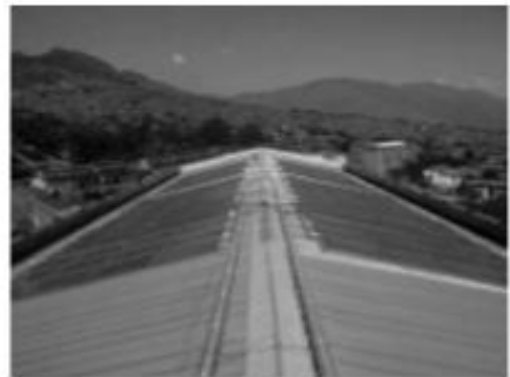
Figura 3. Colectores solares del Hospital Pablo Tobón Uribe, Medellín, en operación desde mediados de los ochenta (20 m 2 de colectores, tanque de 20 m 3 , no visible).
