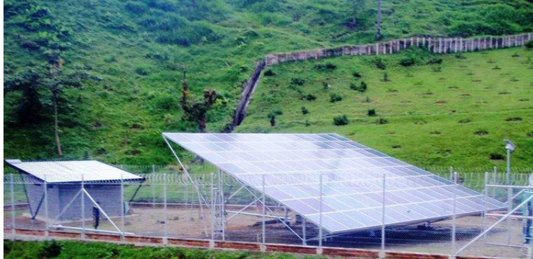
Figura 5. Panel Solar Instalado.
