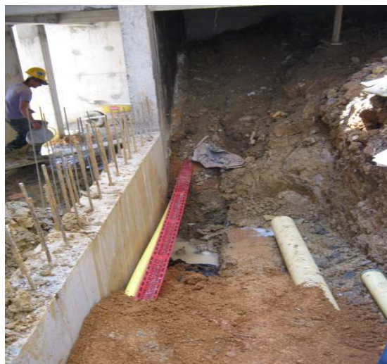
Figura 20. Tubería de polietileno en acometida
