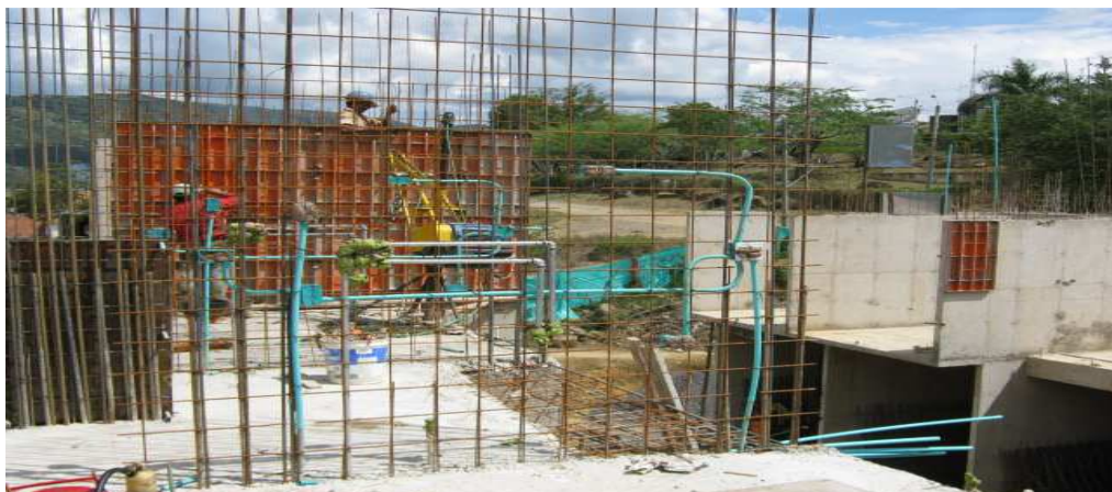
Figura 19. Errores de tubería en muros
