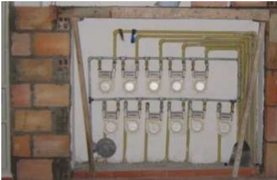
Imagen 4. Centro de medición colectivo en recinto abierto
