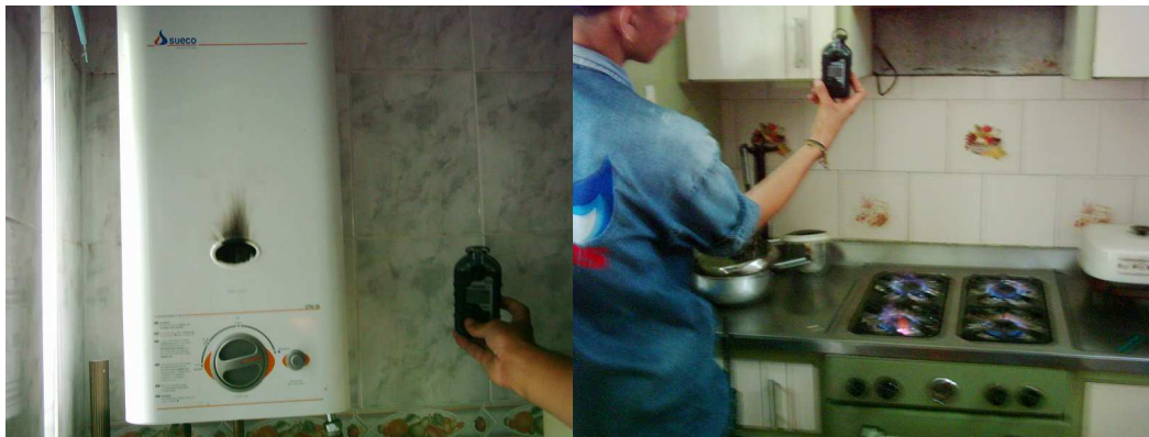
Figura 17. Prueba con el detector de CO
