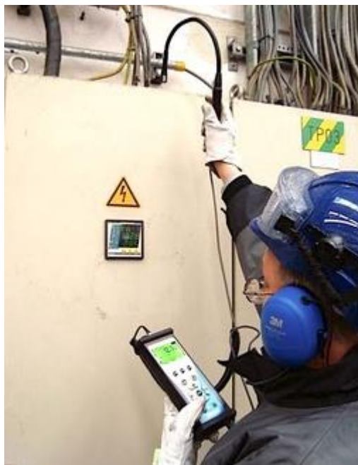
Figura 7. Inspección por medio de equipo de medición de ultrasonido a armario eléctrico de alta tensión
