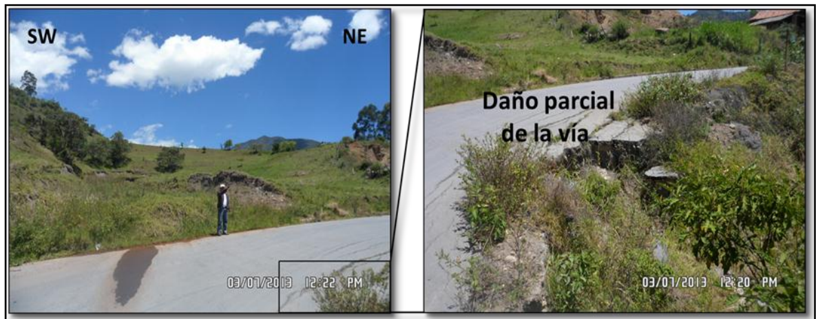
Figura 16. Se observa el daño parcial generado sobre la vía que comunica el casco municipal de Guacamayas con el municipio de San Mateo debido al material desplazado por un deslizamiento traslacional planar. Vereda Uragón, municipio de Guacamayas.
