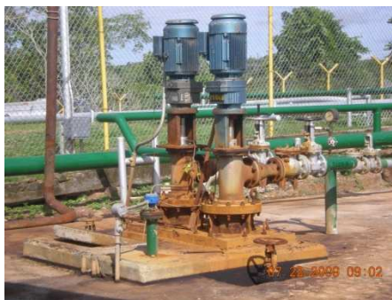
Figura 7A. Corrosión en las bombas debido al alto grado de corrosividad del agua.
