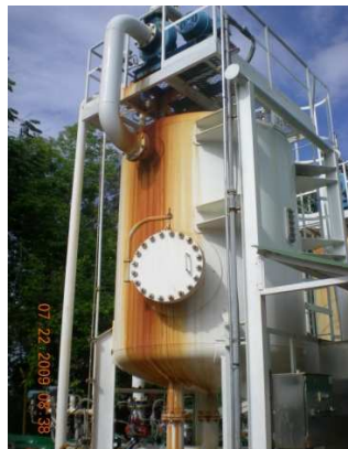
Figura 6A. Corrosión de filtro New Water, debido al derrame de agua en el mantenimiento del scrubber.
