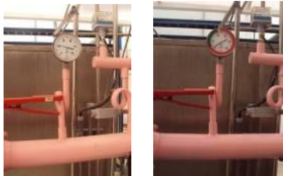
Figura 25. Antes y después de presión de operación de manómetros
