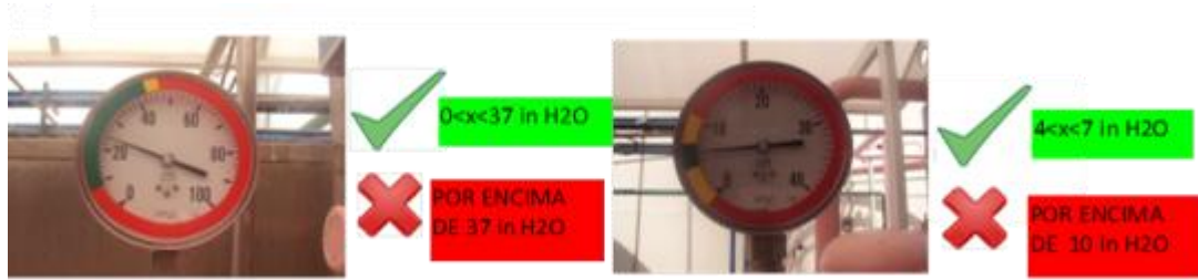
Figura 24. Control visual manómetros succión y descarga sistema de biogás
