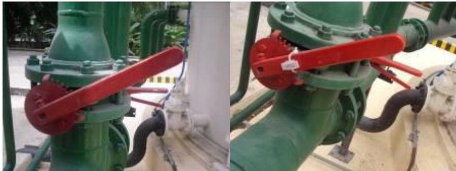
Figura 26. Marcación de válvulas
