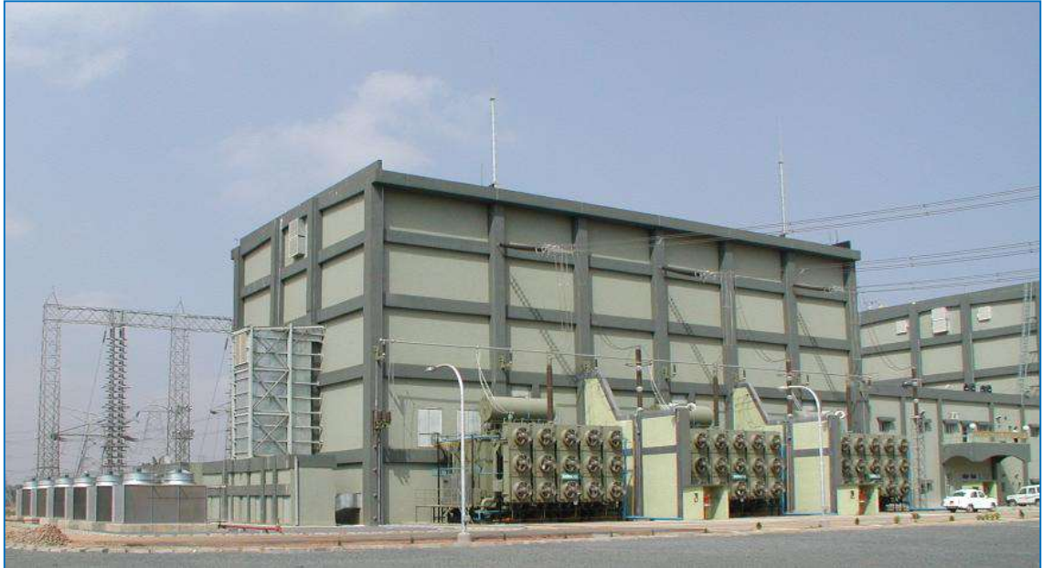
Figura 22. Tres transformadores monofásicos, en la subestación Talcher Kolar, India.
