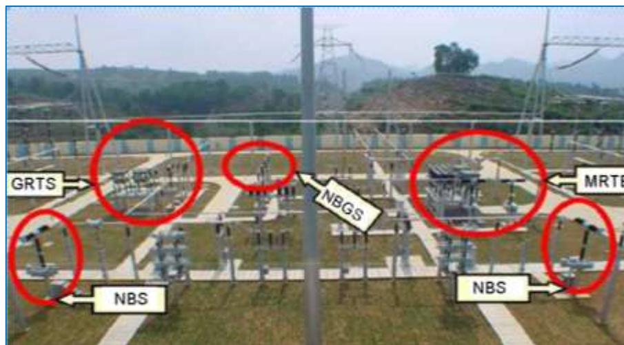
Figura 38. Principales interruptores DC para una subestación convertidora [22].
