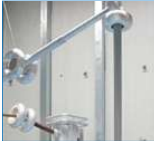
Figura 54. Divisor de tensión para aplicación HVDC de 800 kV [33].
