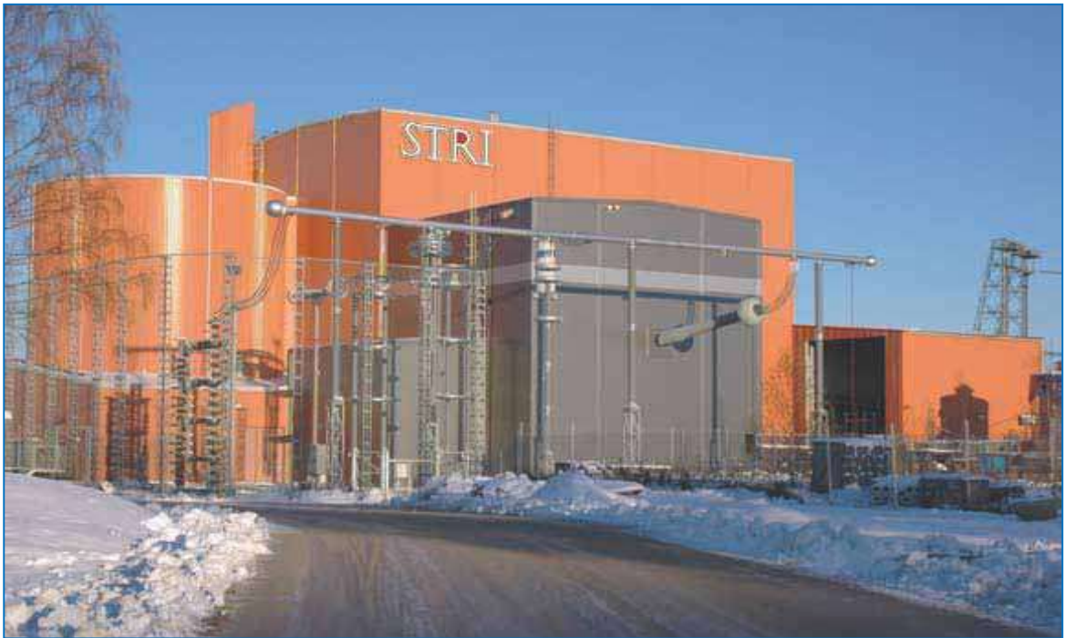
Figura 56. Subestación Stri 800 kV, en Ludvika, Suecia.
