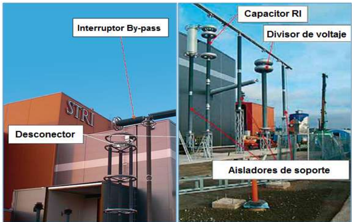
Figura 57. Equipos de patio en DC.
