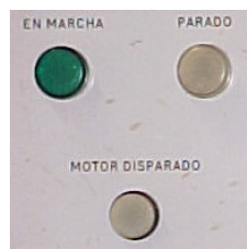
Figura 27. Pilotos de señalización
