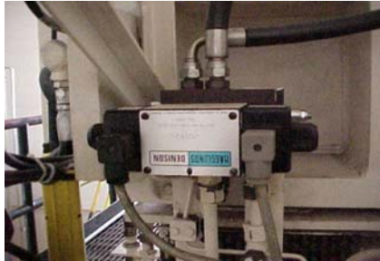
Figura 20. Válvula distribuidora (apertura/cierre) (Fotografía tomada en Bavaria S.A. Cervecería de Boyacá)
