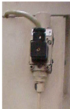
Figura 11. Presóstato baja presión Unidad Motriz Hidráulica (Fotografía tomada en Bavaria S.A. Cervecería de Boyacá)
