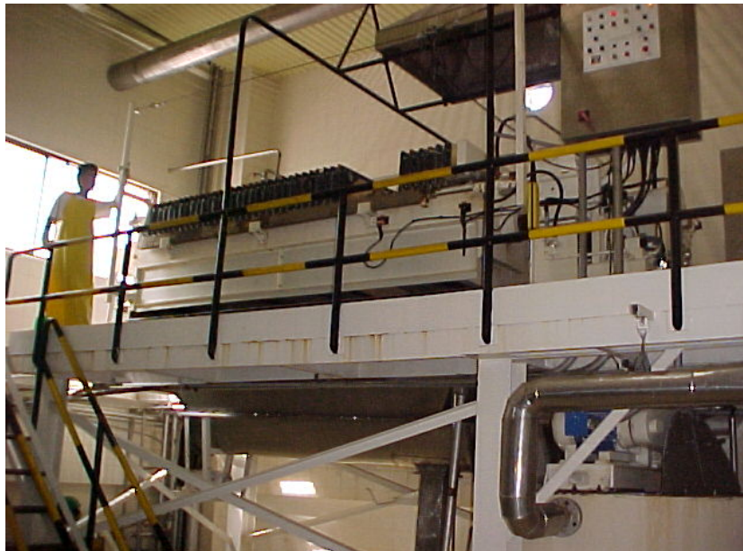
Figura 8. Equipo de Filtro Prensa de Levadura abierto (Fotografía tomada en Bavaria S.A. Cervecería de Boyacá)
