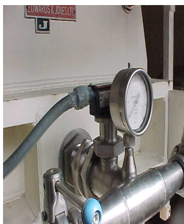
Figura 10. Presóstato instalado en tubería de entrada de levadura (Fotografía tomada en Bavaria S.A. Cervecería de Boyacá)
