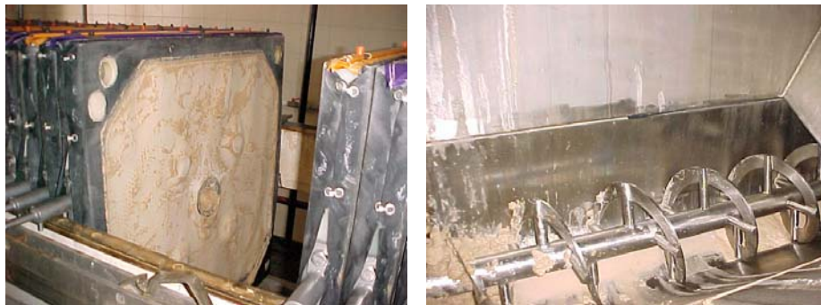
Figura 6. Filtro Prensa abierto, limpieza de placas, tolva y tornillo sinfín (Fotografía tomada en Bavaria S.A Cervecería de Boyacá)
