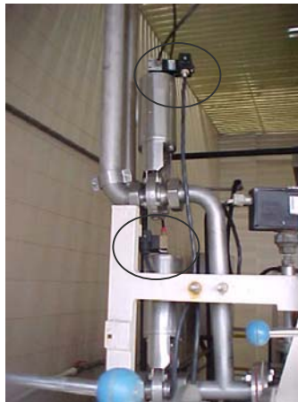
Figura 23. Electroválvulas de unidad neumática (Fotografía tomada en Bavaria S.A. Cervecería de Boyacá)
