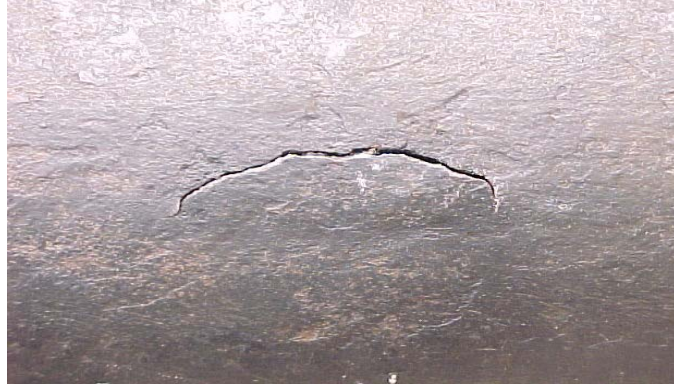
Figura 6. Grieta inducida por la disminución en el espesor de pared.
