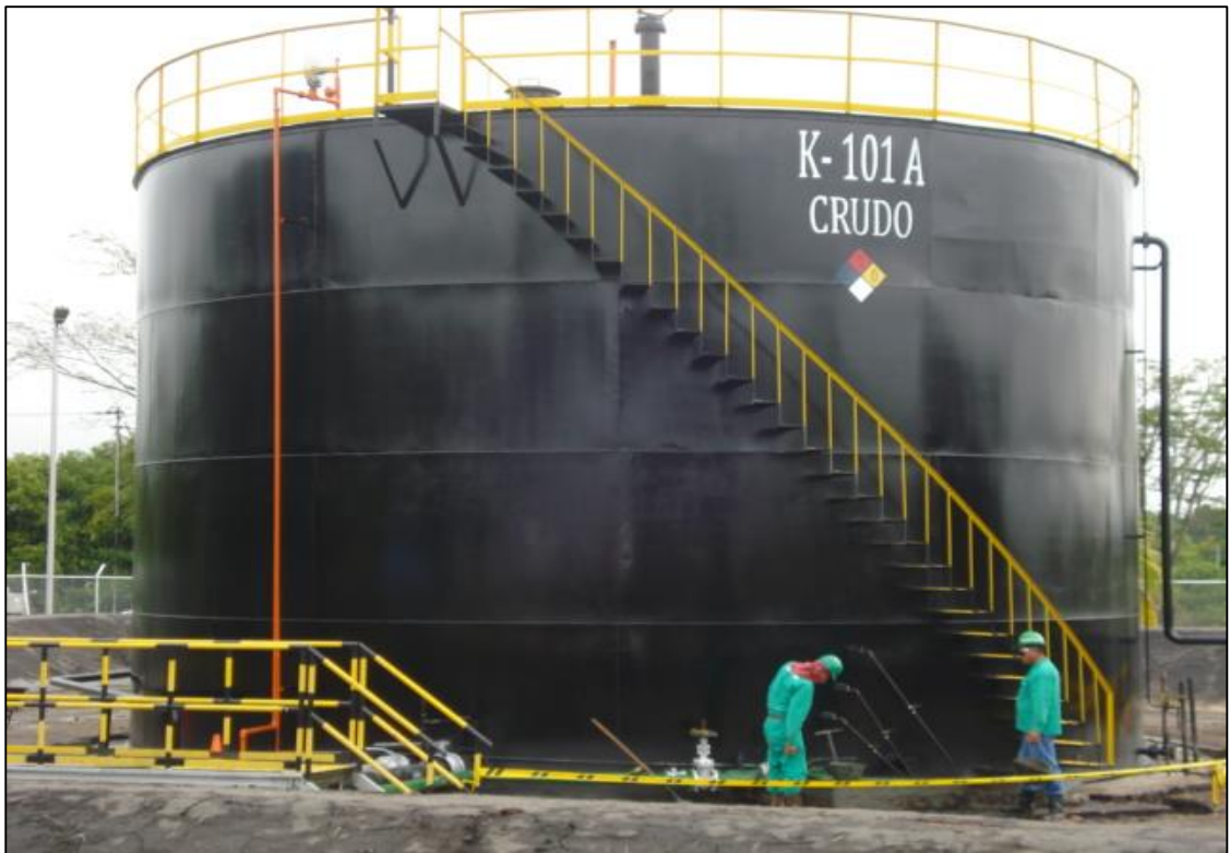
Figura 8. Tanque de almacenamiento ERTC-2
