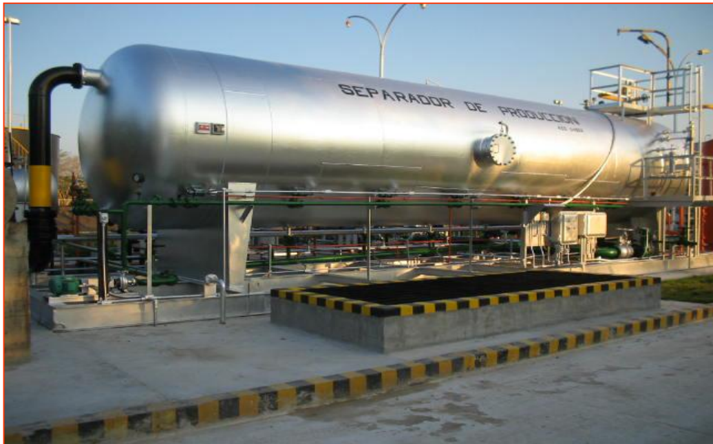
Figura 23. Separador trifásico de la ERTC-2
