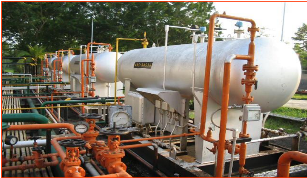
Figura 21. Separadores de prueba de la ERTC-2
