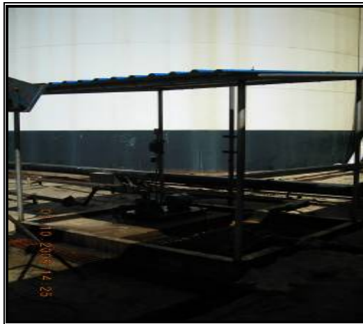
Figura 60. Caja en concreto para centralizar los vertimientos
