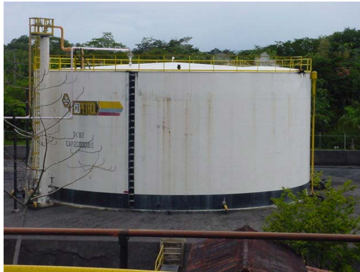
Figura 2. Tanque desnatador o Skim Tank
