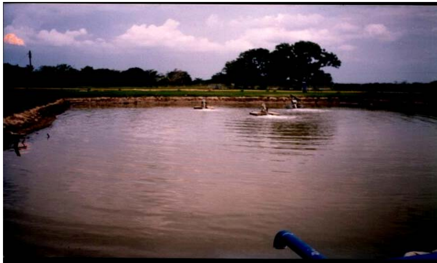
Figura 17. Piscina de oxidación
