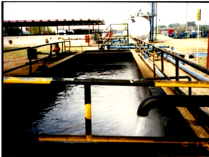
Figura 15. Caja API o separador API
