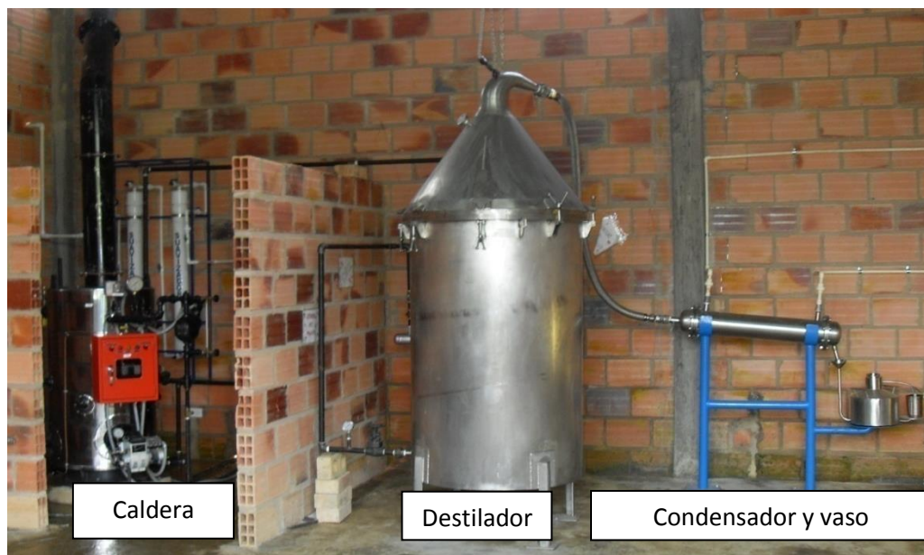
Figura 23. Destilador de aceites esenciales por el método de arrastre con vapor con capacidad de 300 kg de material vegetal, instalado en la Vereda el Retiro, Sucre, Santander. Diciembre de 2010.
