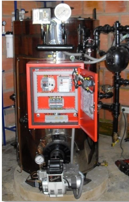
Figura 2. Generador de vapor marca Teknik, instalado en el municipio de Sucre (Santander) y empleado en esta investigación.
