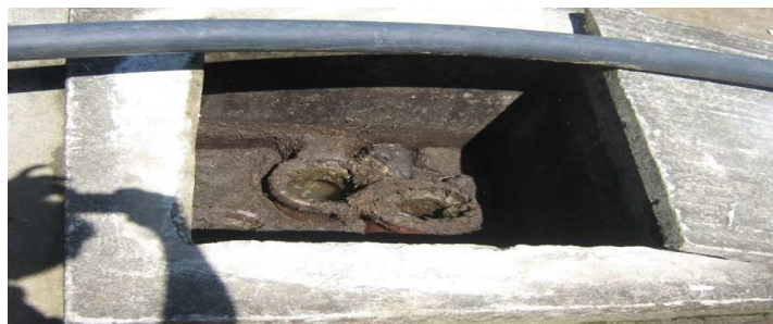
Fotografía 25. Estado de la trampa de grasas
