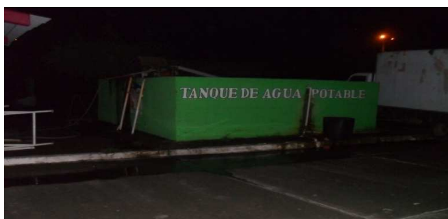
Fotografía 4. Tanque de almacenamiento de agua
