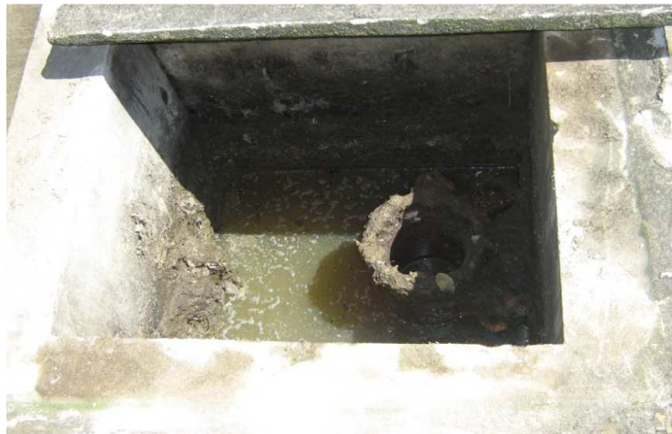
Fotografía 27. Caja de inspección
