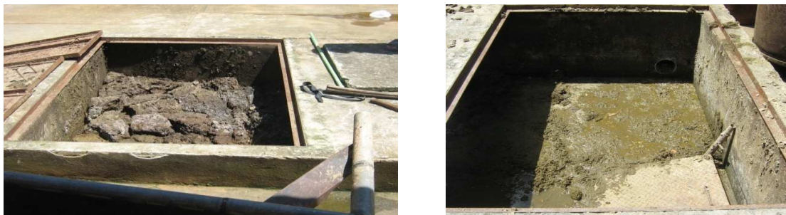
Fotografía 24. Estado de las unidades de sedimentación (colmatada)
