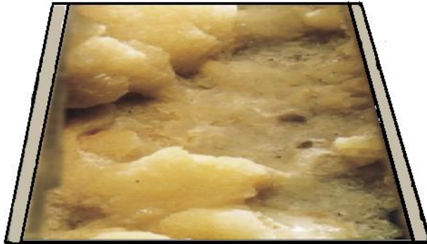
Figura 6. Depósitos de carbonato de calcio en un segmento de tubería.
