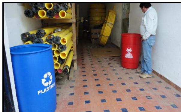
Figura 6. Contenedores para acopio de Residuos peligrosos y materiales plásticos
