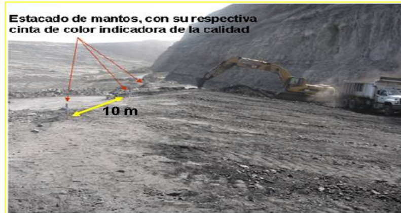
Figura 29. Señalización sobre la cabeza del manto de carbón.
