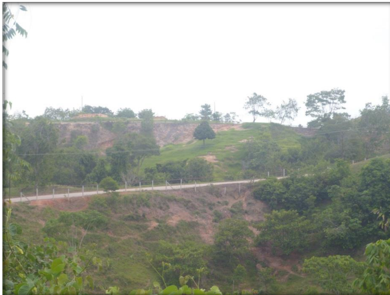
Figura- 24. Panorámica de movimiento 26824 que presenta Reptación y deslizamiento traslacional. Sector conocido como Barrasanta en el municipio de Barrancabermeja.
