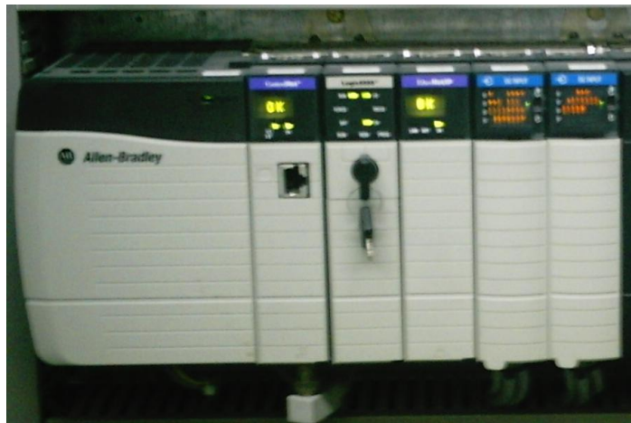
Figura #11: PLC Allen Bradley implantado en las grúas cambiadoras de ánodos.
