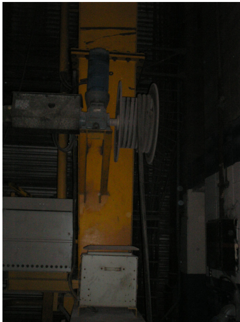
Figura #3: Carrete del Gantry
