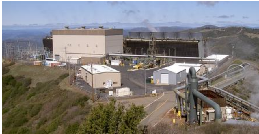
Figura 23. Planta geotérmica en Estados Unidos
