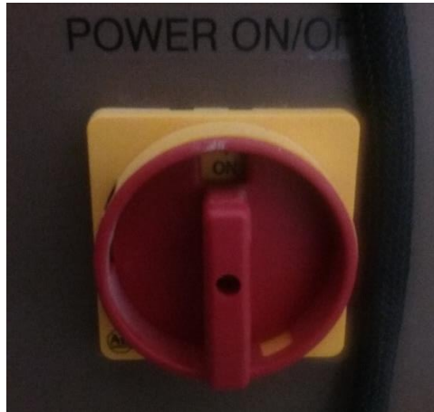
Figura 28. Encendido del actuador
