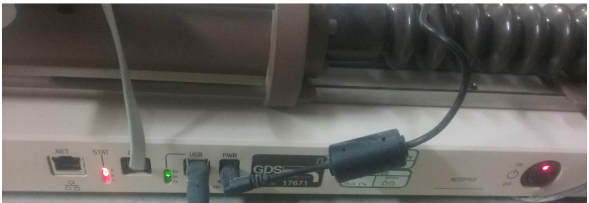
Figura 34. Controlador de presión encendido
