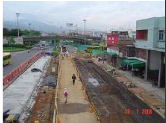
Imagen 96: CII 60 con 15 Puente Peatonal de la puerta del sol Vista Al Sur – Julio 28
