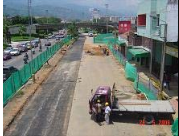
Imagen 94: CII 60 con 15 Puente Peatonal de la puerta del sol Vista Al Sur – Mayo 26
