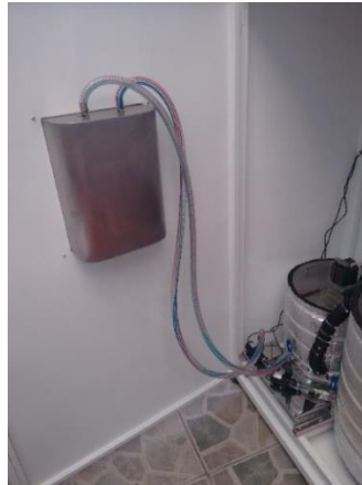
Figura 60. Sistema de bombeo.
