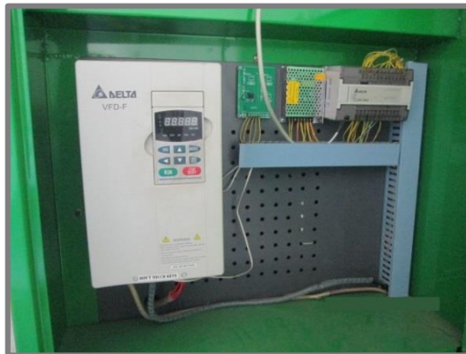
Figura 14. Variador de frecuencia.
