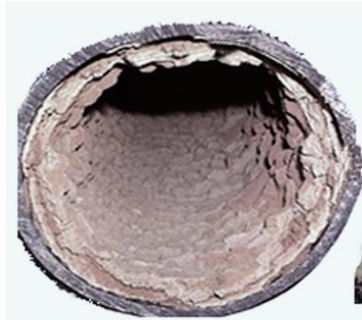
Figura 2 Incrustaciones en tuberías de hierro galvanizado
