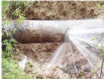
Figura 5 Fuga típica en una tubería de distribución
