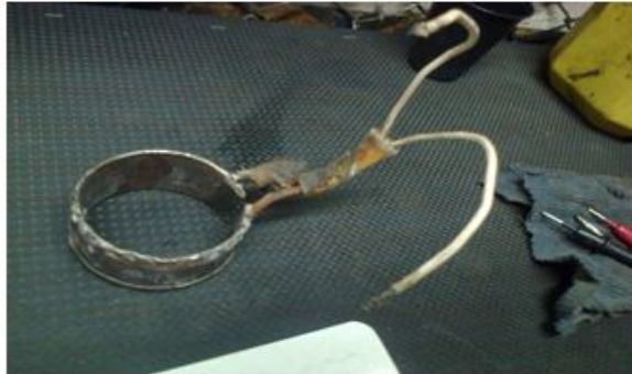
Figura 54: Resistencias quemadas o en mal estado
