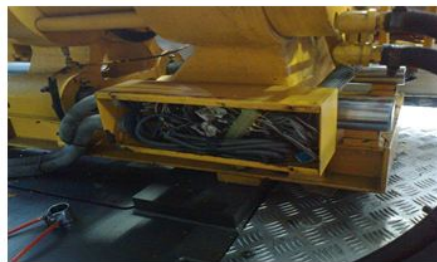
Figura 55: Daños en el cableado del sistema calefacción
