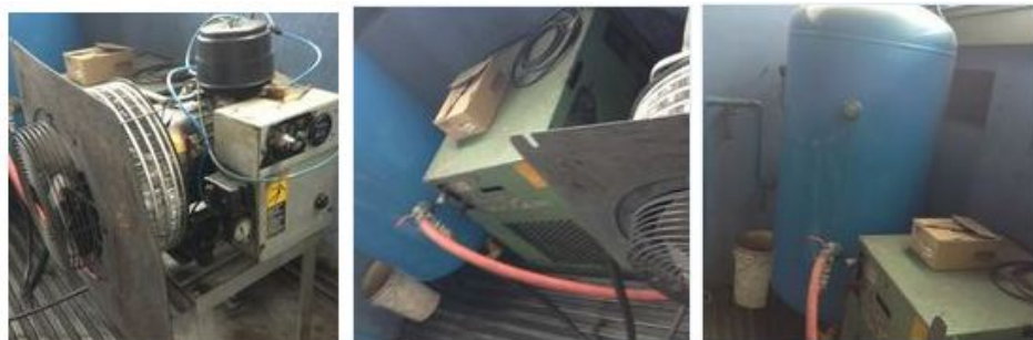
Figura 24: COMPRESORES PARALELO Y ACUMULADOR PLADESAN LTDA
