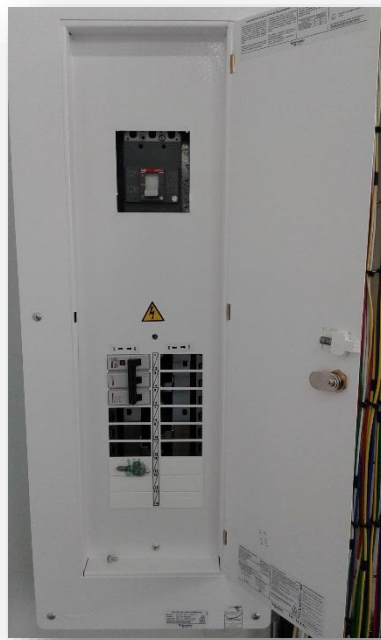
Figura 4. Tablero de distribución secundario
