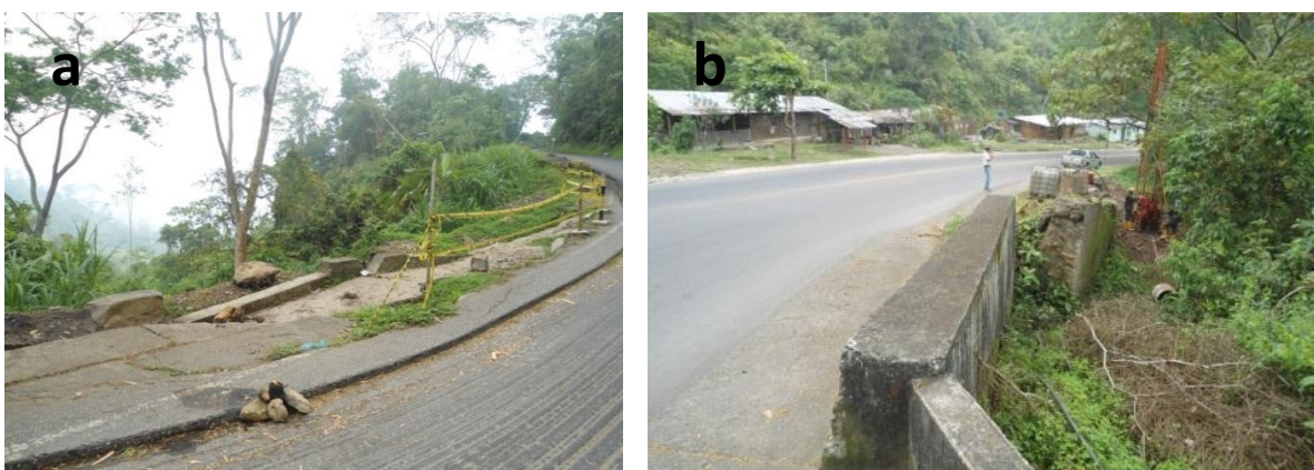
Figura 44. a-b Sector de inestabilidad geologica, Ruta 66, Brisas – La Azufrada, depositos coluviales de media ladera afectados por fenomenos de remocion en masa e inestabilidad, afectando Ruta 66
