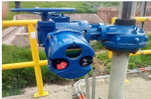
Figura 10 Equipos instalados en el sistema de canales actuador Limitorque
