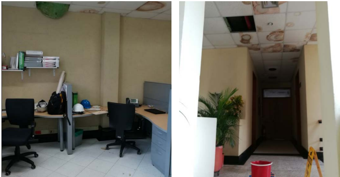
Figura 17. Fallas en cielos rasos y goteras por deterioro en cubierta.
