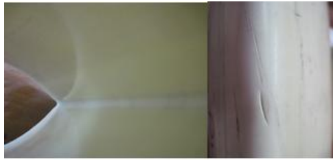
Figura 16. Blanqueamiento lateral externo e interno y fisuras localizada tubería de PVC
