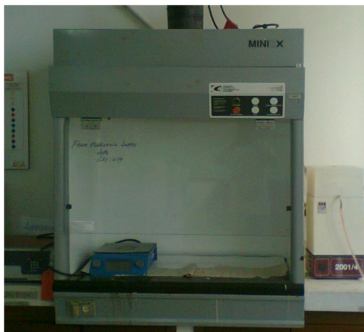
Figura 17. Cabina de extracción de gases
