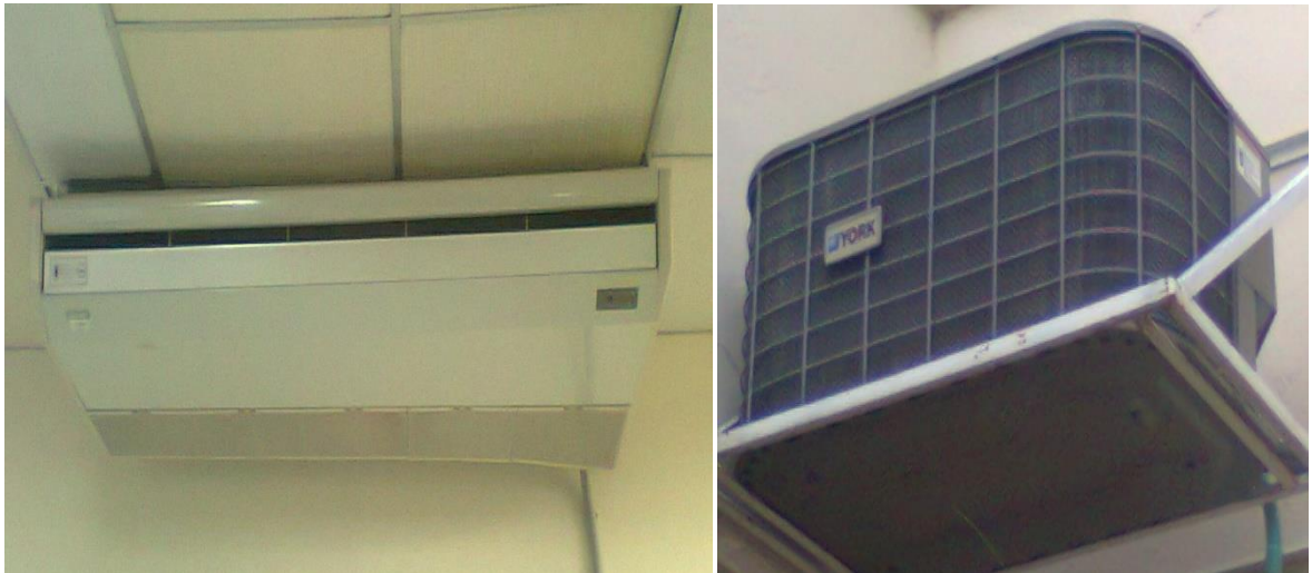
Figura 19. Aire acondicionado tipo minisplit.
