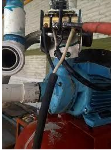
Figura 9. Conexión eléctrica bomba – presostato.
