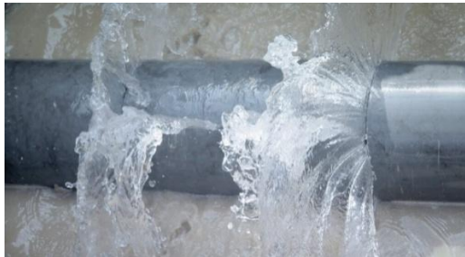
Figura 2. Fugas causadas por presión.
