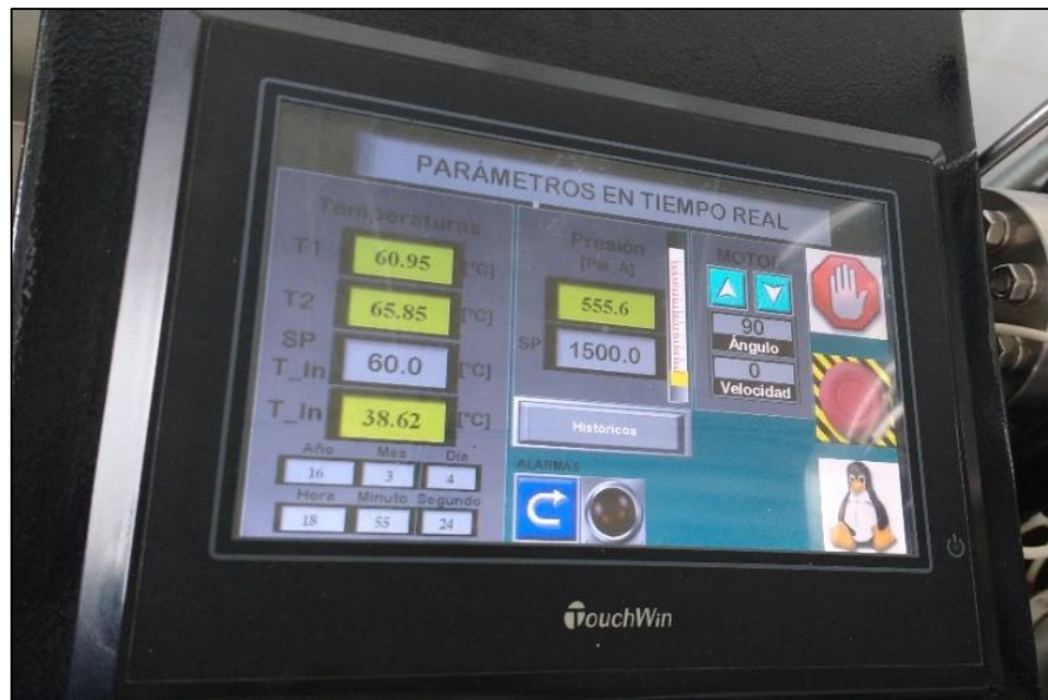
Figura 15. Monitoreo de la presión y las temperaturas del Equipo Bulk 350
