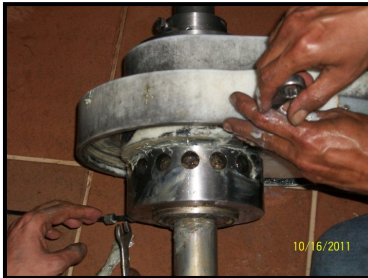
Figura 35 Se muestra procedimiento de desmontaje (manguera y prisionero) para la Manzana 188
