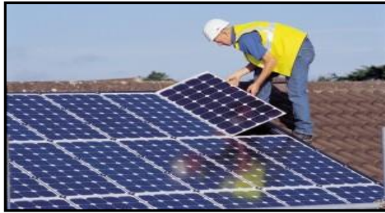
Figura 15. Ubicación de paneles solares en techos. Adaptado de http://www.casasrestauradas.com/energia-solar-ii-paneles-fotovoltaicos/
