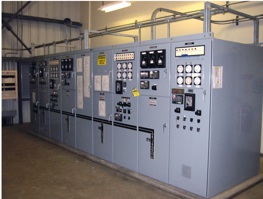
Figura 3.9: Celda de baja tensión Fuente: Central costa sanitary district, planta de tratamiento de agua
