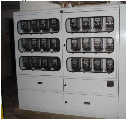
Figura 2. Tablero de contadores
