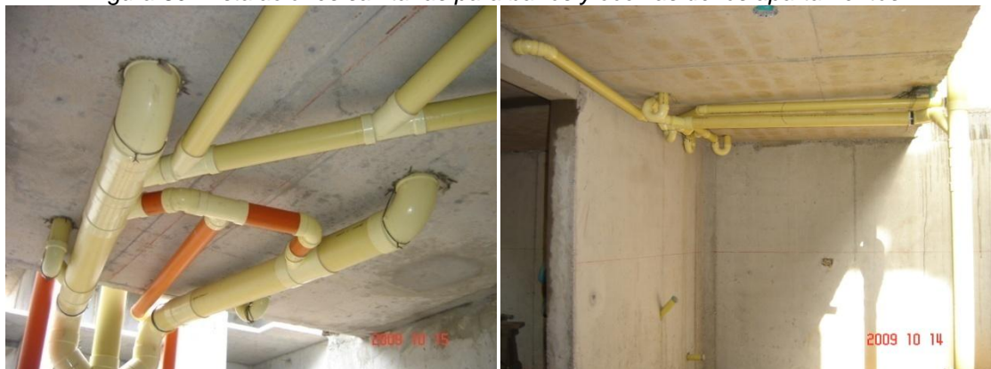
Figura 80. Instalaciones sanitarias para baños y cocinas de los apartamentos.
