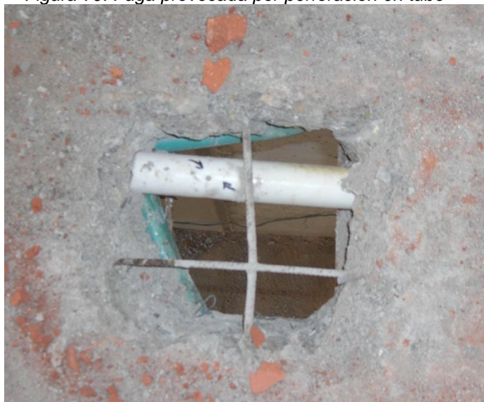
Figura 79. Fuga provocada por perforación en tubo
