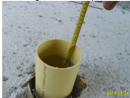
Figura 83. Medición del nivel de agua uno de los puntos de la instalación sanitaria
