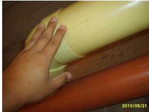
Figura 84. Revisión de los accesorios de la instalación
