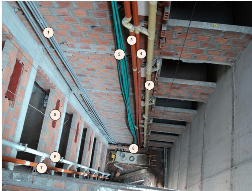
Figura 8. Redes instaladas costado Noroccidental de la Torre 4
