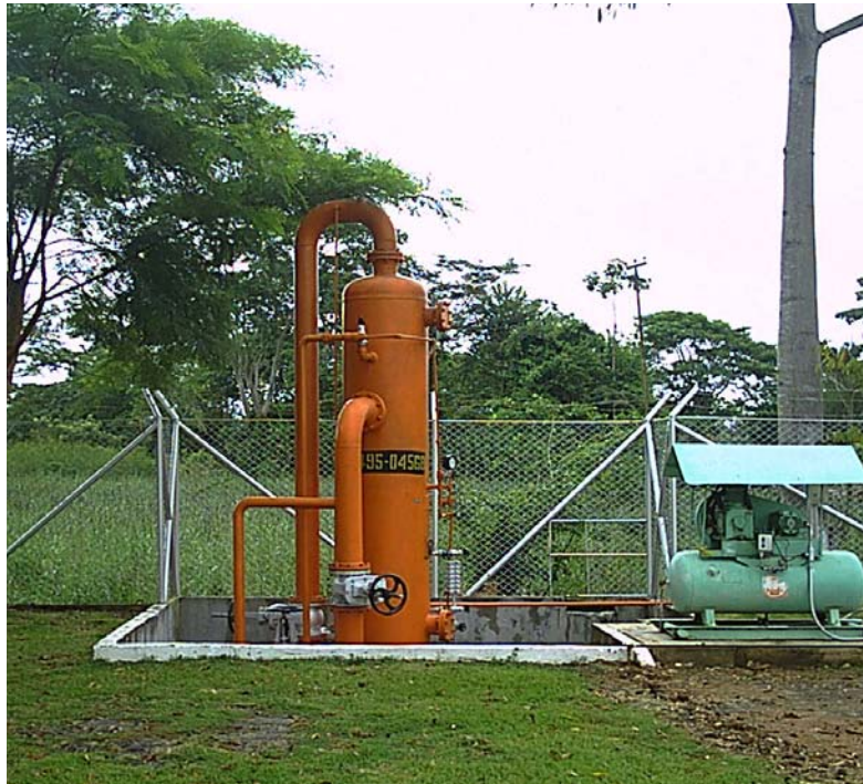
Figura 18. Depurador de la Estación A.
