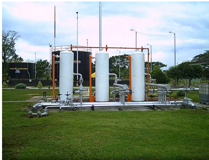
Figura 17. Separadores de la Estación A
